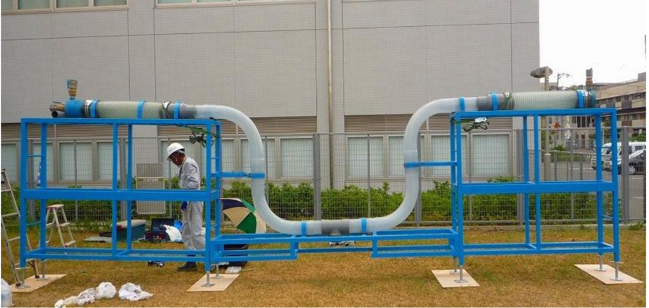
中央部排出用パイプ
